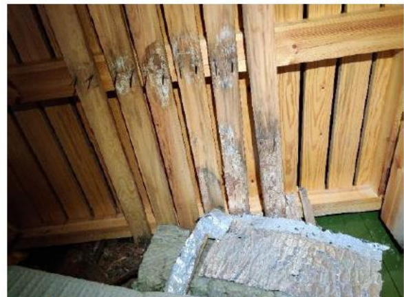
Kuva 10. Purettua yläpohjan rakennusmateriaalia sadevesikourun vuotoalueen ympäristöstä. Puretuissa materiaaleissa esiintyy kosteus- ja mikrobivaurioita, kattopaneeleissa mm. lahottajasientä.
