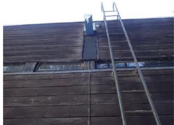
Kuva 8. Räystäskourun liitokset ovat vuotaneet ja kouru on kastellut alapuolisia rakenteita.
